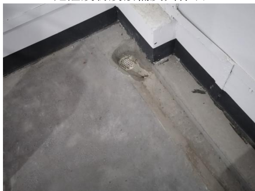
危废间内收集槽
