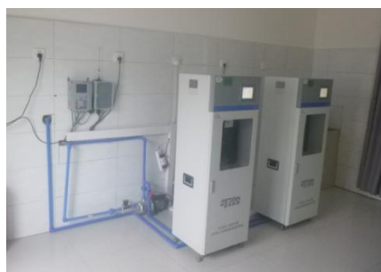
污水处理站出水在线监测（COD、氨氮）
