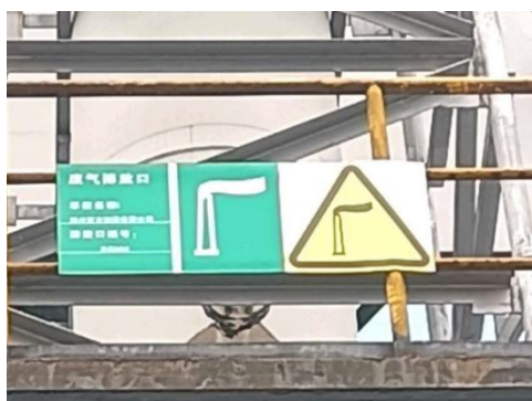
2 车间废气排放口标识
