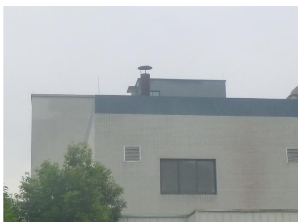
锅炉废气排气筒
