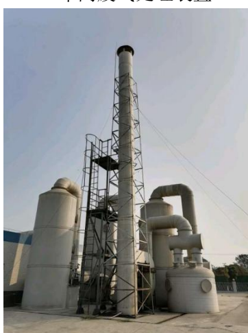
罐区、甲类库房、污水处理站废气处理装置
